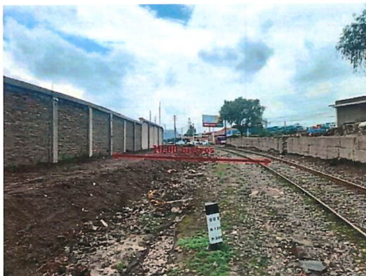
Figura N°09 – Cerco perimétrico (Propiedad del Sr. Jaime Delgado), colindante con la vía férrea. Coincide con los límites de propiedad de la concesión.
